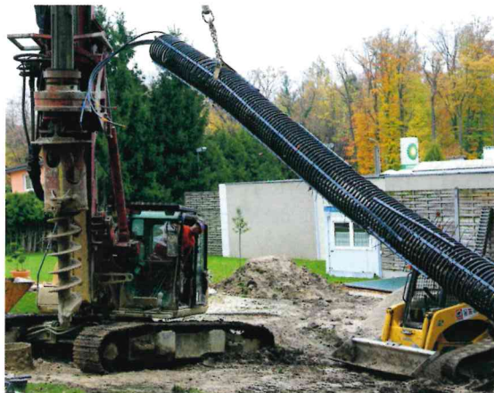
Bild 5: Belegung von Sonderformen – Spiralkollektoren © VÖBU
